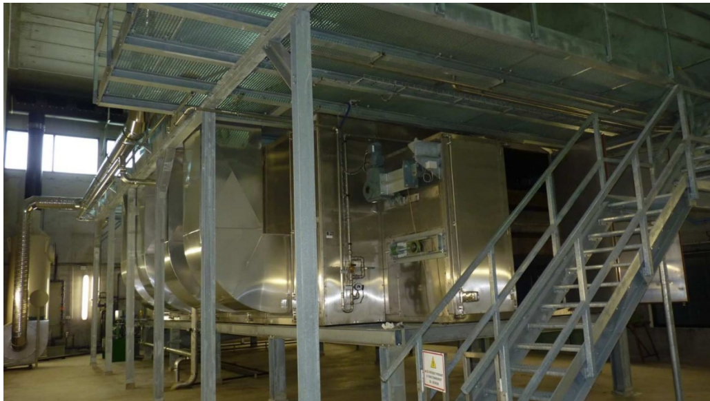
Sécheur thermique de Cherbourg
