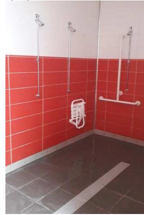
Equipements de douche
