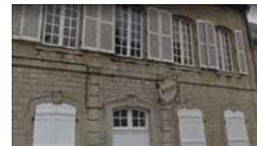
Motif ondulant des appuis. Hôtel du trésor de la Roque. 1770-1778. 40-42, rue de Poterie.
