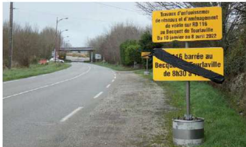
→ Les travaux, avec la mise en place d'une déviation, doivent débuter dès lundi prochain.
