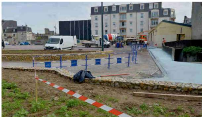
→ Suite à une campagne de fouilles archéologiques de l'INRAP en mars 2019, il était impossible de creuser à plus de 40 cm dans le sol pour préserver les vestiges antiques et médiévaux.
