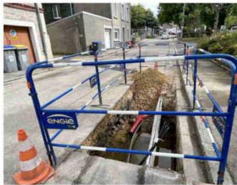
→ Rue Trottebecq, le chantier pour le passage de câbles et la pose d'une boîte de dérivation devrait se terminer le 30 août.
