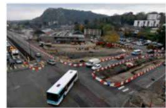
→ À Cherbourg, les chantiers du BNG seront suspendus du jeudi 22 décembre 2022 au mardi 3 janvier 2023.
