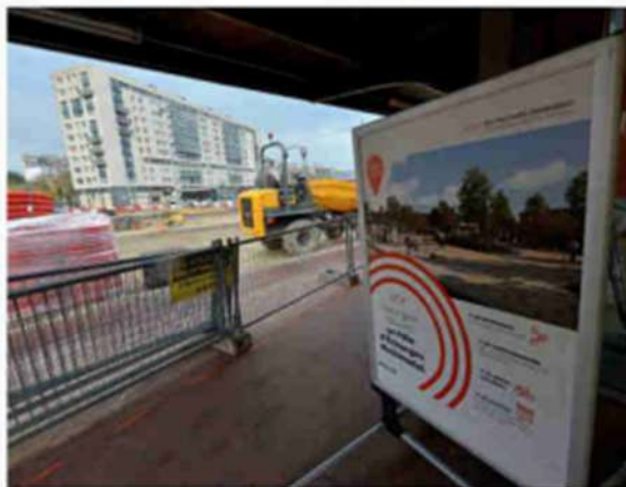
→ Les contours du futur parvis sont dessinés. Le local de l'ancien fleuriste, au pied du grand immeuble du carrefour (au second plan), deviendra le bureau commercial de Cap Cotentin.
