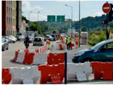
→ Avenue Carnot. Du 5 septembre au 23 septembre : travaux sur les trottoirs pour création de la future voirie provisoire de la circulation. La passerelle piétonne est également fermée.
