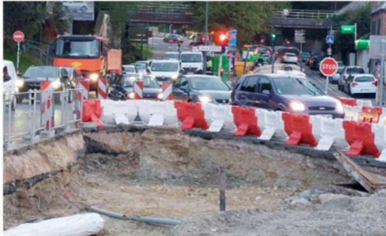
→ Les bouchons liés aux travaux, comme ici à la gare, peuvent dissuader certains automobilistes de venir faire leurs emplettes en centre-ville.
