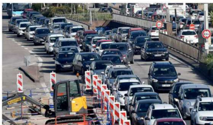
► À Cherbourg-en-Cotentin, les travaux pour le bus nouvelle génération impactent fortement la circulation.
